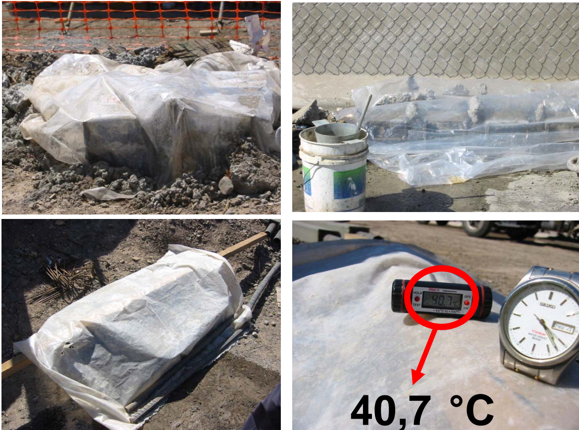
Figura 3. Curado inadecuado de probetas en obra
